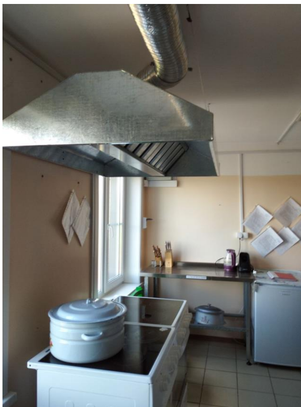
Рис. 2 Вытяжная система на пищеблоке МКДОУ ДС с. Подволошино
